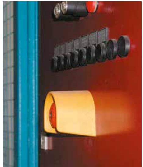
Bild 2-18: Unzulässiger Not-Aus-Schalter mit Kragen. Schalter hätte versetzt werden können
