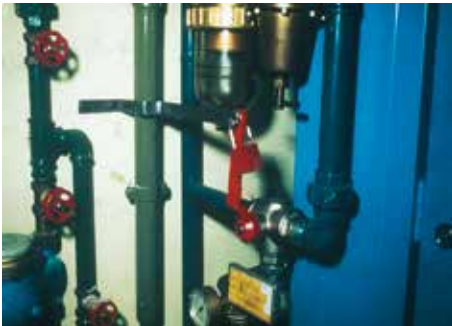
Bild 2-19: Abschließbarer Hauptschalter für die Pneumatik
