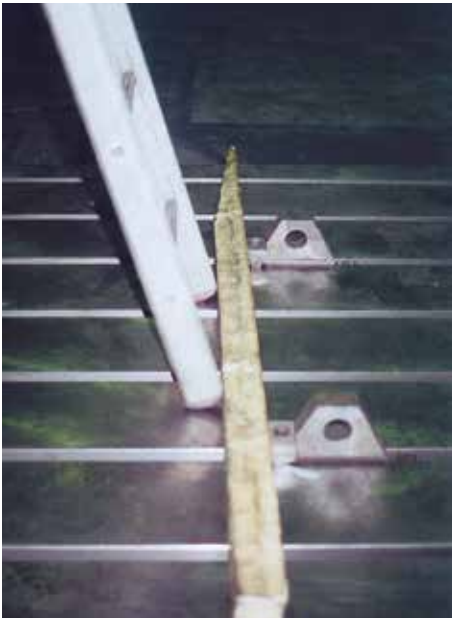
Bild 2-7: Ungeeignete Sicherung einer Leiter gegen Wegrutschen
