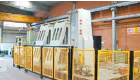
Bild 2-52: Bearbeitungszentrum mit Umzäunung
