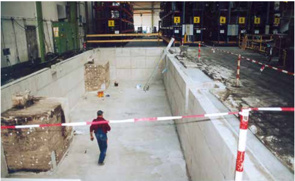
Bild 2-11: Unzulässige Maßnahme gegen Absturz (Flatterband) an der Fundamentgrubenkante
