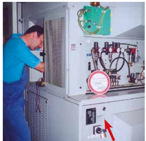
Bild 2-57: Sichere Störungsbeseitigung; Absicherung mittels Vorhängeschloss
