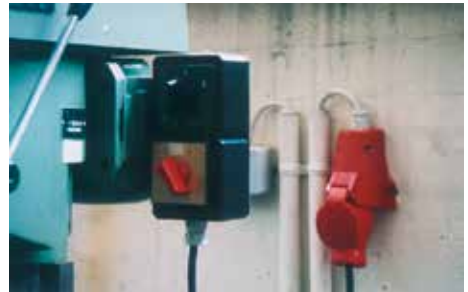
Bild 2-20: Kleinere Maschine mit Anschluss über Steckvorrichtung und Not-Aus integriert im Ein-Aus-Schalter
