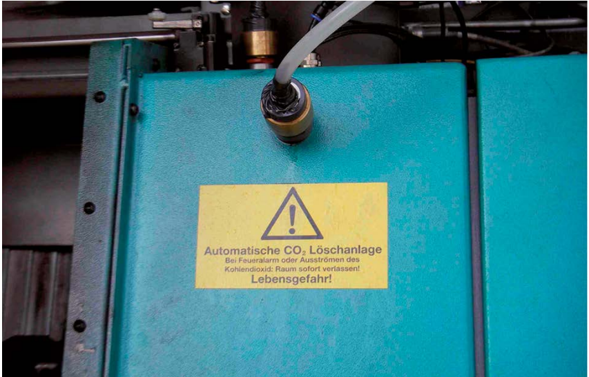
Abb. 58 Warnhinweis auf Gefahren von Löschgass \text{CO}_2
