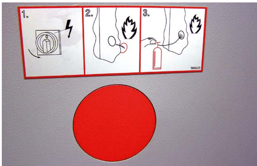
Abb. 49 Löschoffnung mit Kennzeichnung und Hinweisen
