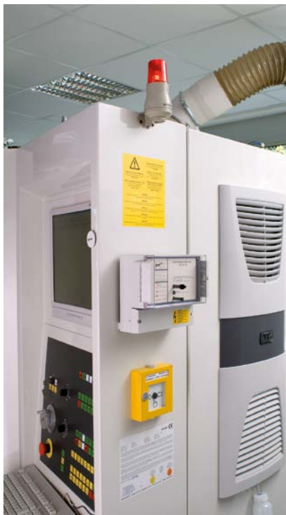
Abb. 52 Brandmeldezentrale mit Handauslösung
