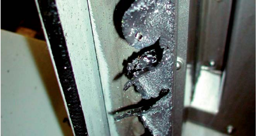
Abb. 28 Türdichtung brandschutztechnisch nicht geeignet
