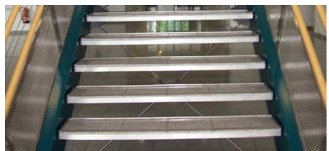
Abb. 2 Treppe ohne Setzstufe
