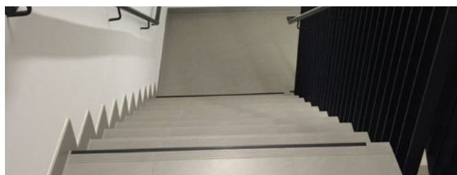
Abb. 14 Geflieste Treppe in Arbeitsstätten, unzureichend gekennzeichnet
