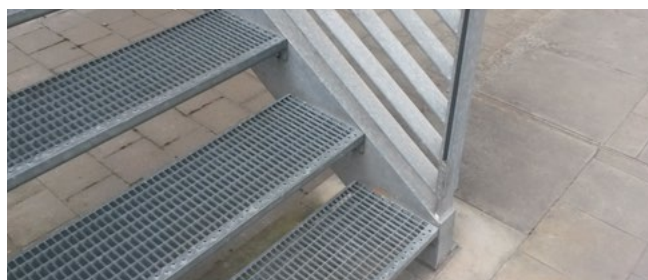
Abb. 15 Nicht geeignete Treppe für Menschen mit Fußhebeschwäche
