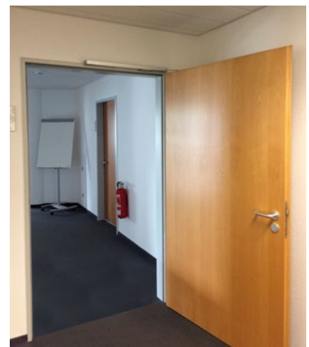
Abb. 10 Offen gehaltene Feuer- und Rauchschutztür
