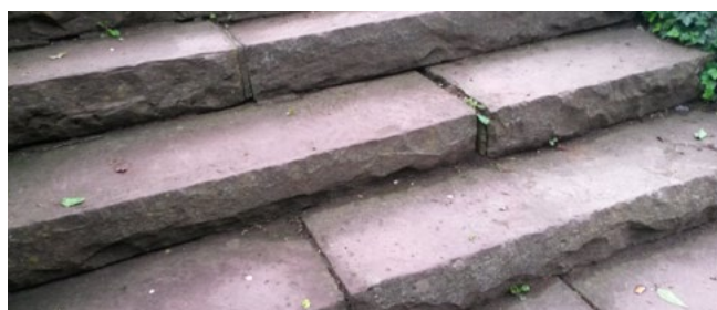
Abb. 16 Außentreppe mit erhöhtem Abrieb
