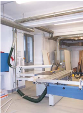
Abb. 1 Holzbearbeitungsmaschine mit Absaugung
