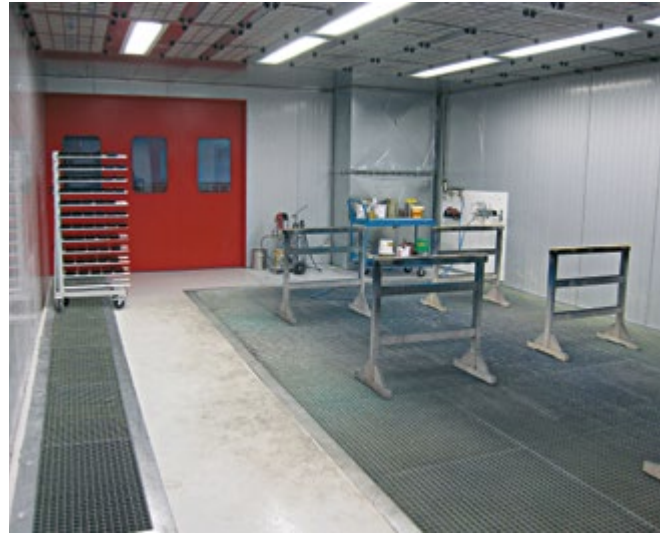
Abb. 29 Lackierraum, links Abluftanlage für frisch beschichtete Teile
