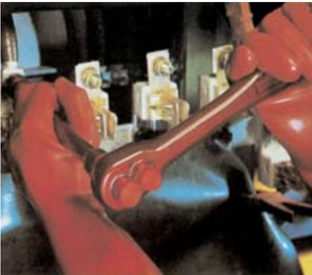
Bild 14-3: Anwendung einer Umschaltknarre mit Isolation nach VDE bei gleichzeitiger Benutzung von isolierenden Handschuhen und Abdeckung der übrigen Kontaktteile durch Isoliertuch
