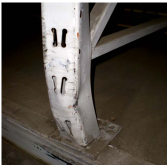
Abb. 12 Gerissene Schweißnaht an der Fußplatte der Stütze
