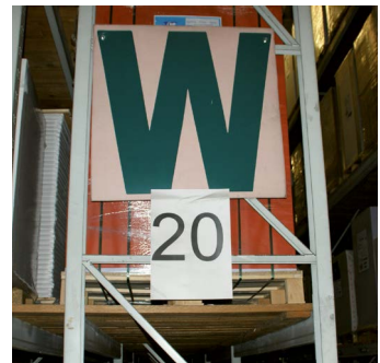
Abb. 15 zu tief eingelagerte Palette führt zu einer Überlastung der inneren Stützen und Trägern
