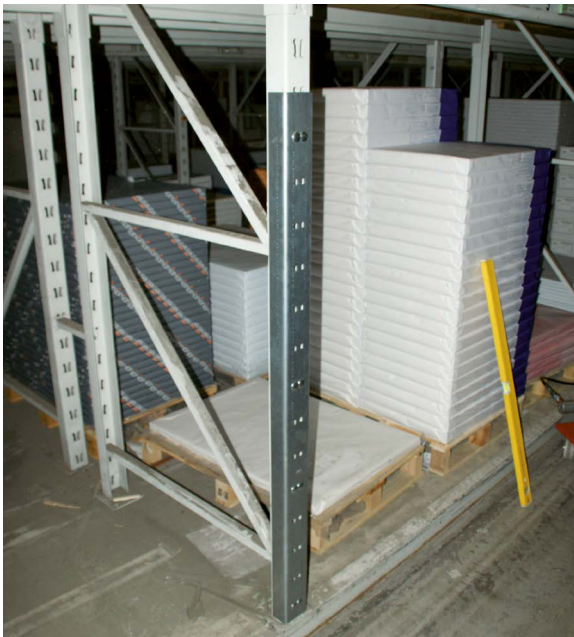
Abb. 18 Repariertes Regal: nach dem Richten wurde die Stütze mit einer Verstärkung versehen
