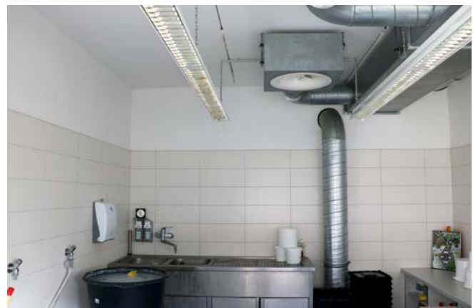
Abb. 14 Entsorgungsarbeitsplatz einer Pathologie mit Lochblechabsaugung und Zuluft im Deckenbereich
