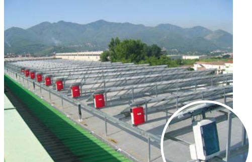
Abb. 18 Mehrere Leitungen des PV-Modulfeldes werden in Generatoranschlusskästen zusammengeführt. Von hier aus gelangen die Hauptleitungen zum Wechselrichter. Die einzelnen Modulleitungen sind untereinander mit Steckverbindern gekoppelt. Diese dürfen nicht geöffnet werden, da dabei die Gefahr eines Lichtbogens besteht.
