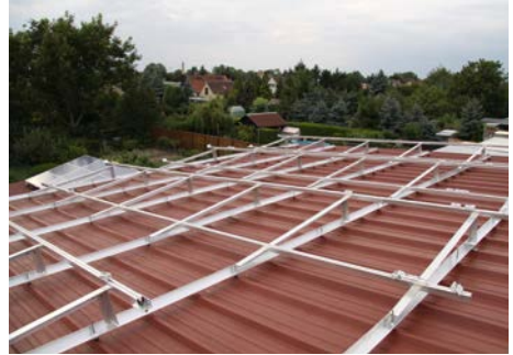
Abb. 16 Durch das Montagegestell sind die Module fest mit dem darunter liegenden Dach verbunden. Die eingesetzten Verbindungstechniken können nicht ohne weiteres entfernt werden, damit sie Schnee und Sturm standhalten. Die Befestigung stellt auch einen wichtigen Teil des Diebstahlschutzes dar.
