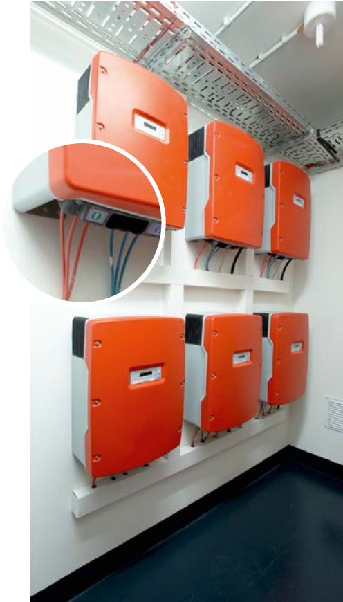
Abb. 19 Wechselrichter können, je nach Gebäude-situation, wie hier im Hausanschlussraum oder aber auch an anderer Stelle installiert sein. Links unten an den Wechselrichtern sind die integrierten DC-Freischalter zu erkennen. PV-Anlagen sind unter Umständen erst dann vollständig freigeschaltet, wenn an allen beteiligten Wechselrichtern der DC-Freischalter betätigt wurde.
