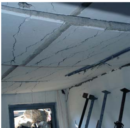
Akute Einsturzgefahr des gesamten Gebäudes! Im Bild die Kellerdecke
