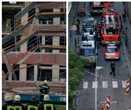
Der Gefahrenbereich ist auch für Einsatzkräfte abgesperrt.
