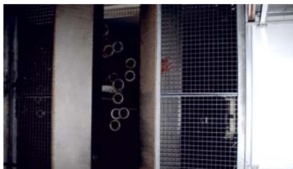
Schutzdach im Turm mit Betriebsdurchlass für die Schläuche (von unten in den Turm hinein fotografiert)
