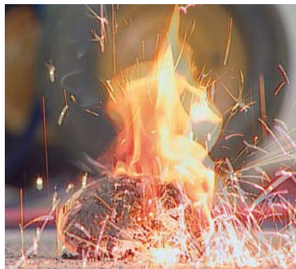
Hohe Zündenergie: Funkenflug bei Brennschneidarbeiten
