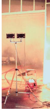
Einsatzstellenbeleuchtung durch Halogen-Flutlichtstrahler auf Teleskop-Dreibeinstativ
