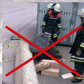
Gefahr! Durch Hubvorgänge darf keine instabile Lage der Last entstehen.
