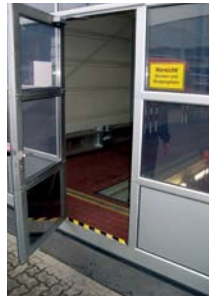
Warnung am Zugang vor der dahinter liegenden Arbeitsöffnung der Grube – das Warnzeichen fehlt.
