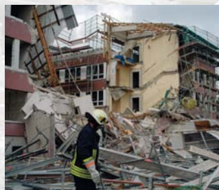
Einsturz eines Gebäudes durch unsachgemäße Bauarbeiten
